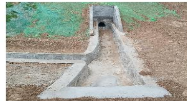
外区排水口及破水墙（2）
