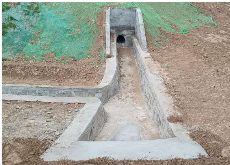
外围排水口及截水槽（2）
