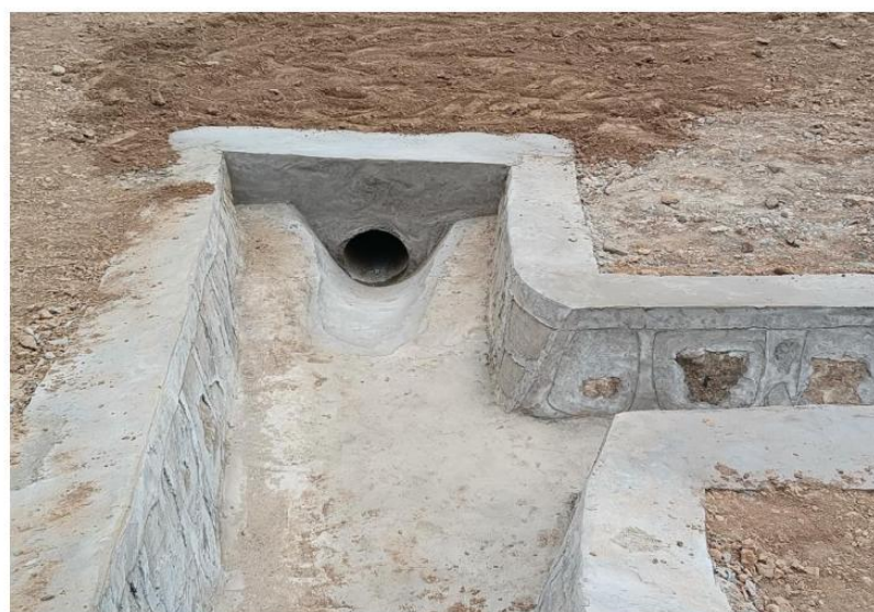
外围排水口及截水槽（3）
