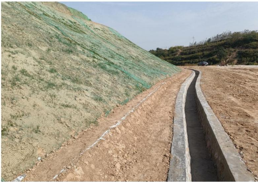
外围排水口及截水槽（1）
