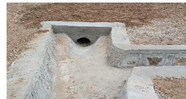
外区排水口及破水墙（3）
